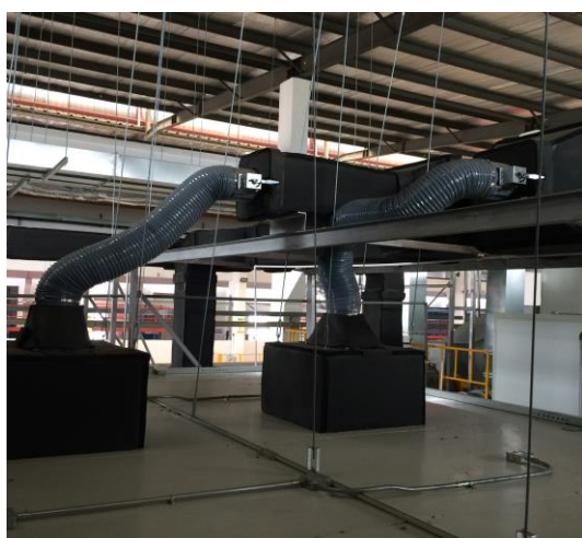
喷漆有机废气处理设施
