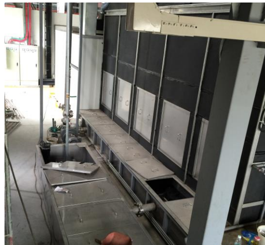
水帘除漆废水处理装置
