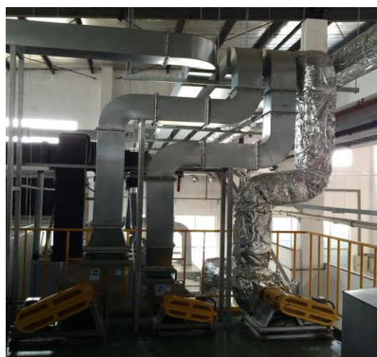
调漆、烘烤有机废气处理设施
