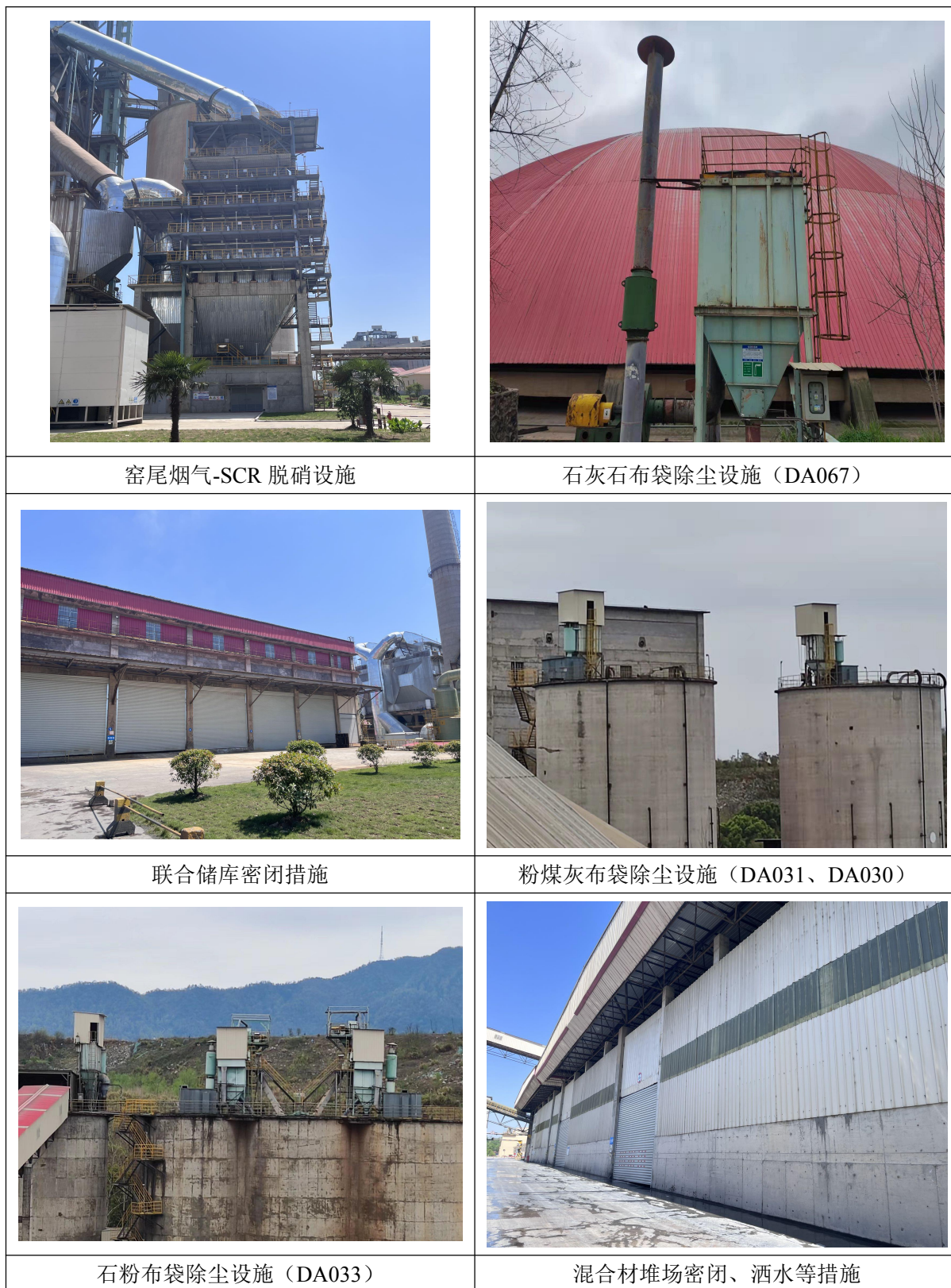
图 4.1-2 废气治理设施现场照片
