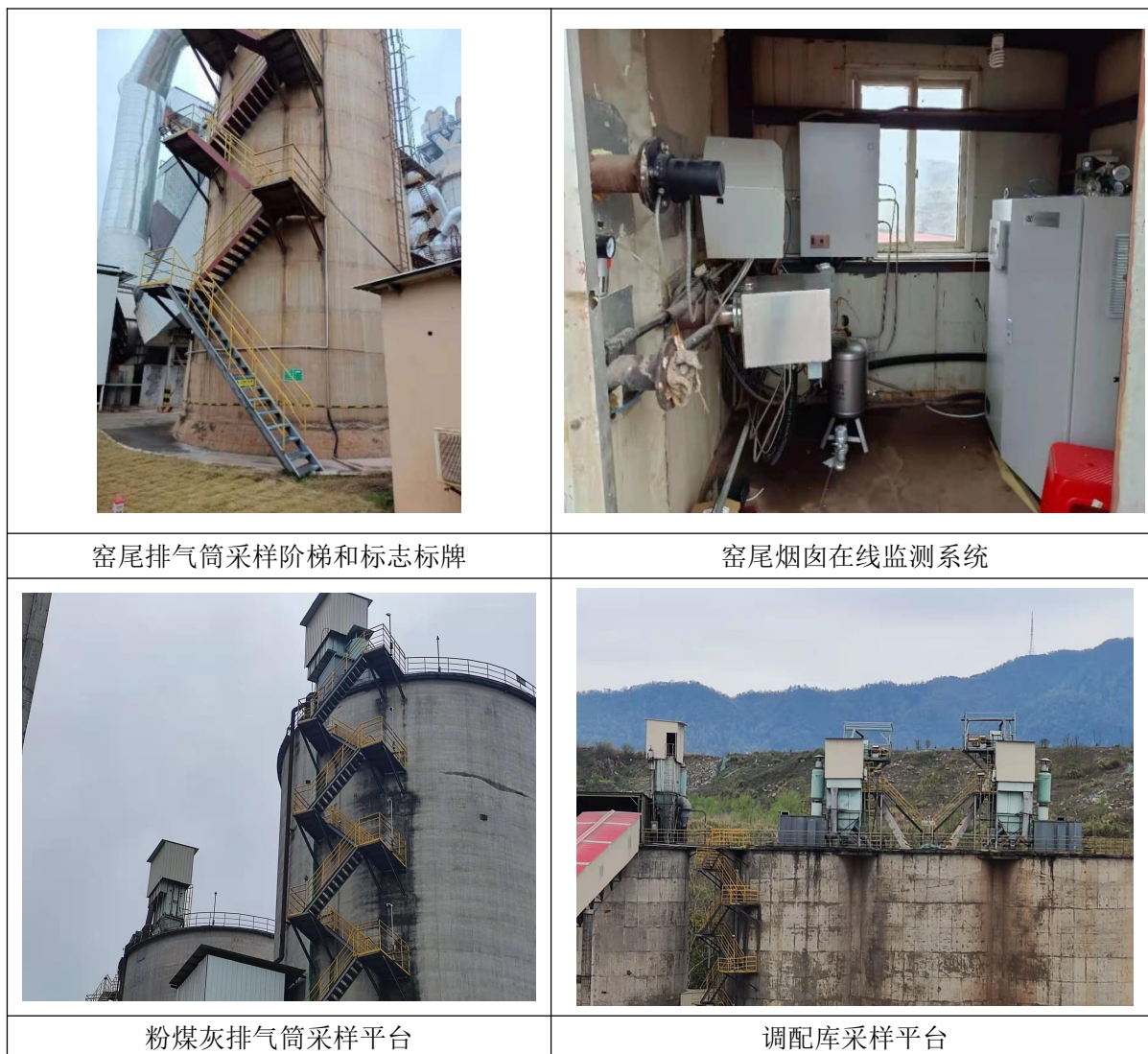
图 4.2-2 排污口规范化建设及在线监测装置现场照片
