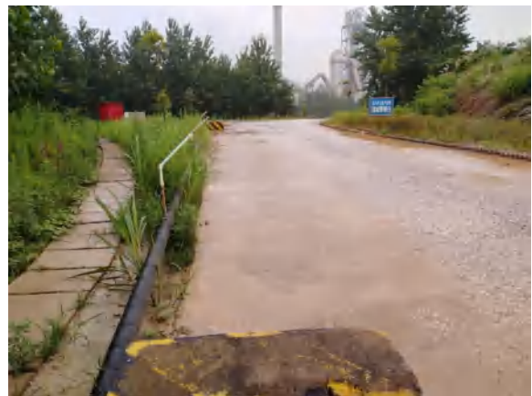
沿路喷淋装置
