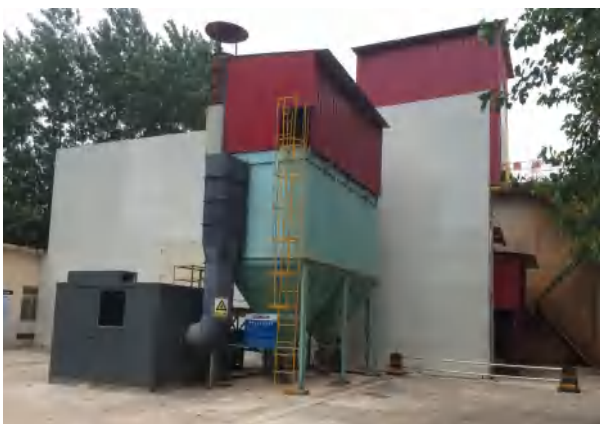
布袋除尘器+15m高排气筒
