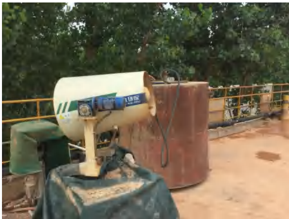
喷雾除尘装置
