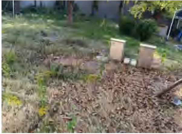
埋地生活污水处理设施
