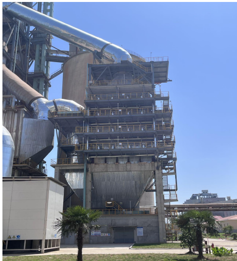
窑尾烟气-SCR 脱硝设施
