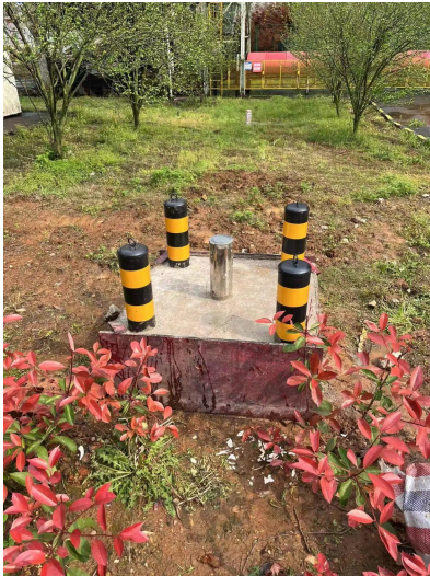
3#地下水监测井（1#危废暂存库西北侧）
