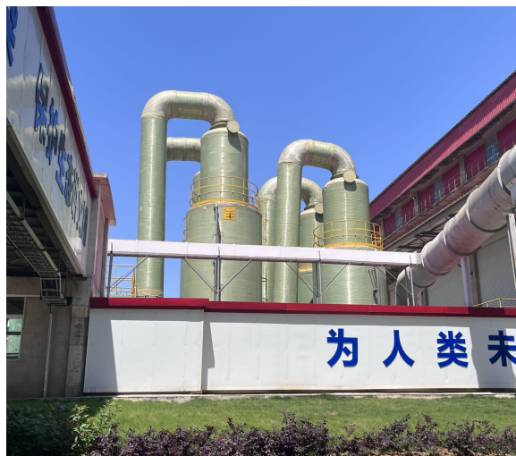
固废储存及输送车间备用活性炭吸附装置 (DA002)
